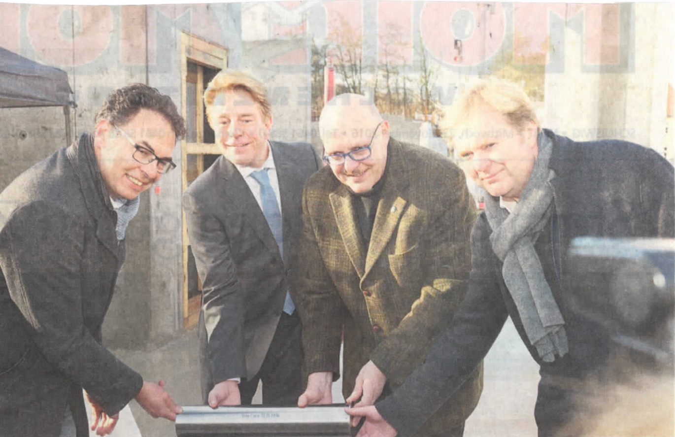
haben gemeinsam den Grundstein für die neue Seniorenresidenz am Schloss gelegt: Alexander Göggel, Andreas Anspach, Dr. Arthur Christiansen und Jens Kruse (v.l.). Foto: Kleimann-Balke
